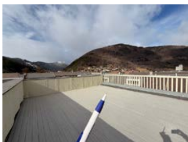
Avvik rekkverk på terrassen.
