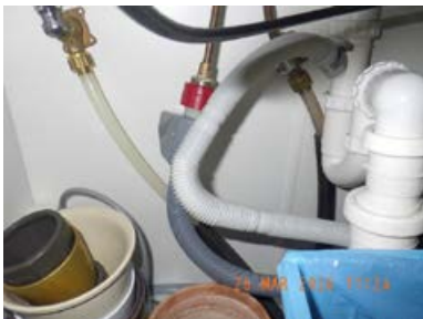
Manglende endemuffer på vannrør
