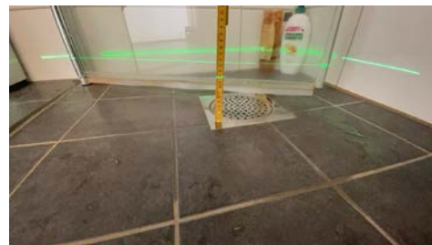
Høydeforskjell (ved sluk)
