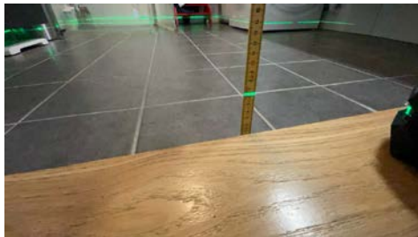
Høydeforskjell (flis ved terskel)
