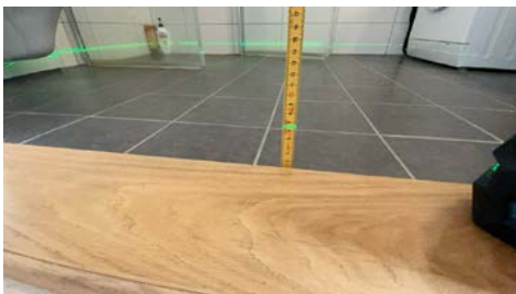
Høydeforskjell (flis ved terskel)
