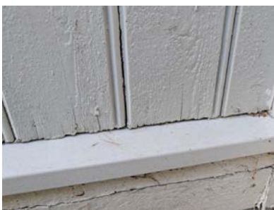
Oppsprukket treverk og endeoppsprekking ved utbygg.
