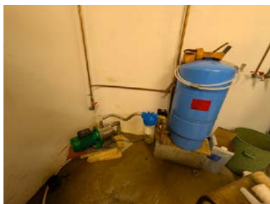
Membrantankanlegg i kjeller låve/driftsbygning.
