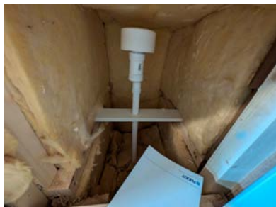
Durgo bak luke ved bad 2.etasje
