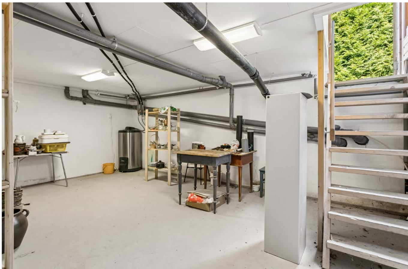
Kjeller med utvendig adkomst. Varmtvannsbereder på ca. 200 liter fra 2019.
