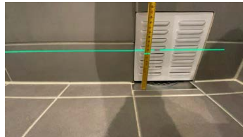
Høydeforskjell (ved sluk)
