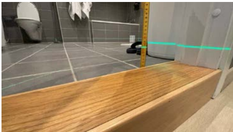
Høydeforskjell (flis ved terskel)
