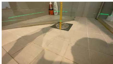
Høydeforskjell (ved sluk)
