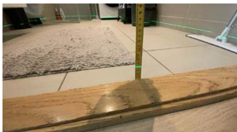
Høydeforskjell (flis ved terskel)
