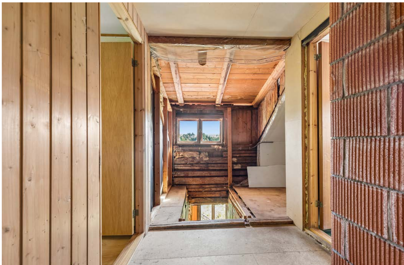
Gang i andre etasje er delvis revet. Ark/takopplett er ikke dokumentert søkt/godkjent.
