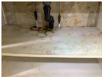
Svellskadet hylleplate i servantskap.
