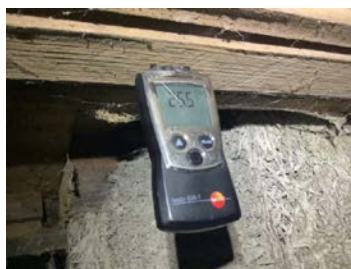
Det måles skadelig fuktinnhold i himling i kjeller som følge av høy luftfuktighet.
