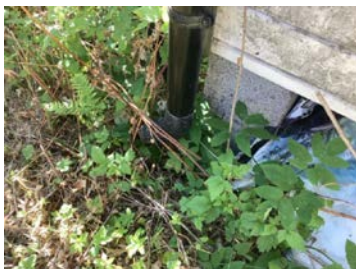
Eksempel på mangelfull bortledning av takvann.
