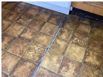
Slitasjeskader i gulvbelegg.
