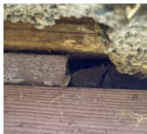
Eksempel på manglende gnagsikring.
