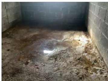
Vann på gulvet i kjeller.
