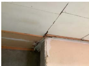
Fuktskjolder i himling rundt pipe.
