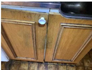
Eksempel på slitasje på innredning.
