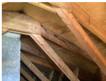
Fuktskjolder i taktro rundt pipe.
