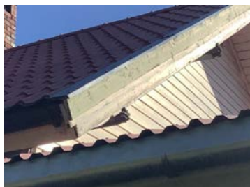
Utskåret ende av toppsvill ser ut til å være råteskadet.
