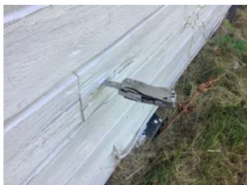
Eksempel på råteskadet kledning.
