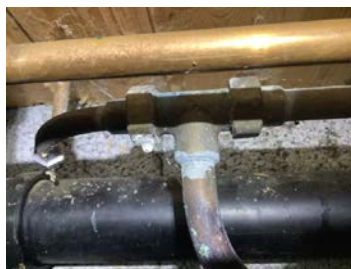
Drypplekkasje fra kobling.
