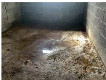
Vann på gulv i kjeller.
