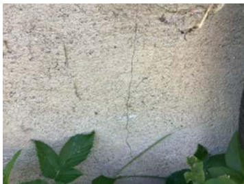
Eksempel på skråriss i grunnmur.
