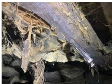
Eksempel på skadet bjelke som følge av råte eller insekter.
