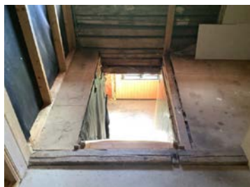
Returrekkverk mangler rundt trapp i andre etasje.
