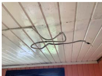
Avklippet kabel i himling, og denne er ikke festet.
