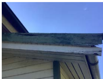
Råteskader i vindskier.
