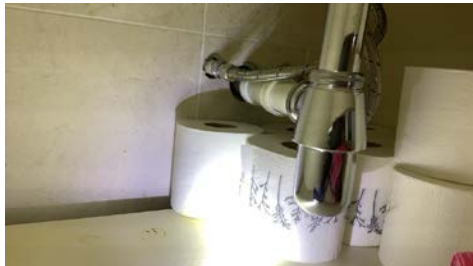
Rørgjennomføringer er ikke tette.
