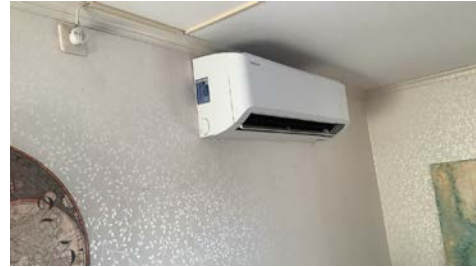
Varmpumpe fra 2022 er plassert i stue.
