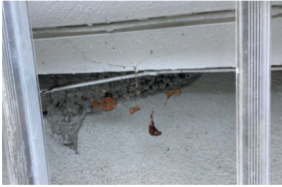
Avskalling av murpuss.
