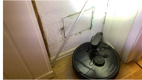
Det er brennbare materialer nærmere enn 30 cm fra sotluke.
