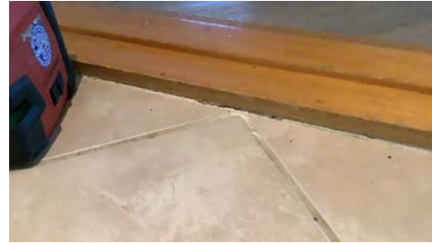
Det er ikke etablert oppkant ved terskel
