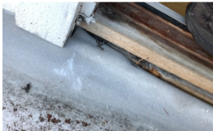
Membran på veranda over inngangspartiet er ikke tett.
