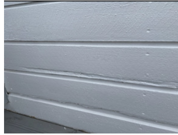
Det er registrert skader på kledning.
