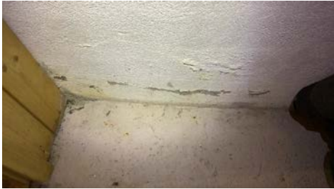
Saltutslag og malingsflask tyder på fuktgjennomslag.
