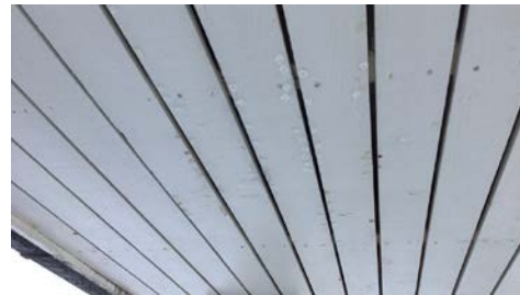
Det er lekkasje i membran fra veranda i 2. etasje mot sør med adkomst fra stue.
