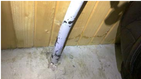
Det er registrert fuktmerker på påforet trevegg.
