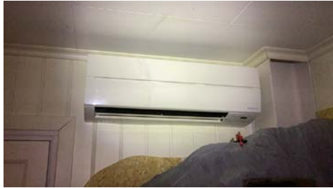
Eldre varmpumpe er plassert i kjellerrom.
