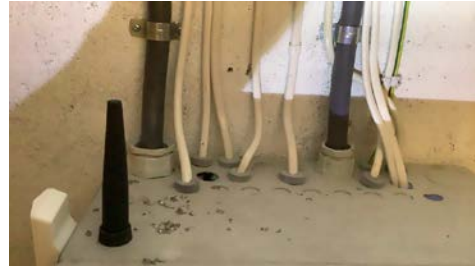
Det er åpninger som ikke er tettet i sikringskap.
