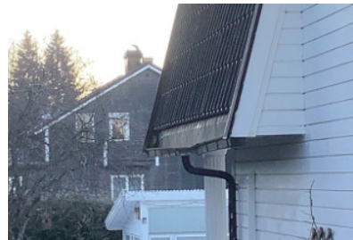
Skjevheter i takrenne er registrert.
