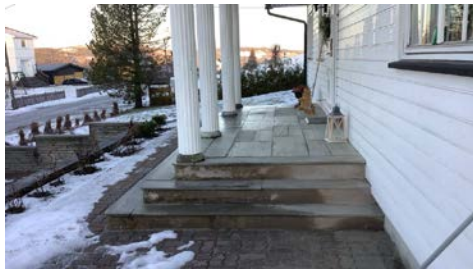
Platting og trapp foran inngang av betong belagt med sliferplater.
