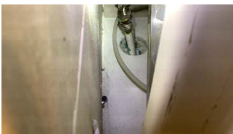
Gjennomføring i vegg i dusjsonen.
