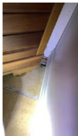
Gulvet er ikke tett. Tidligere vegg er fjernet.
