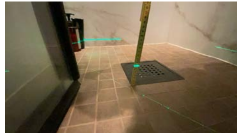
Høydeforskjell (ved sluk)
