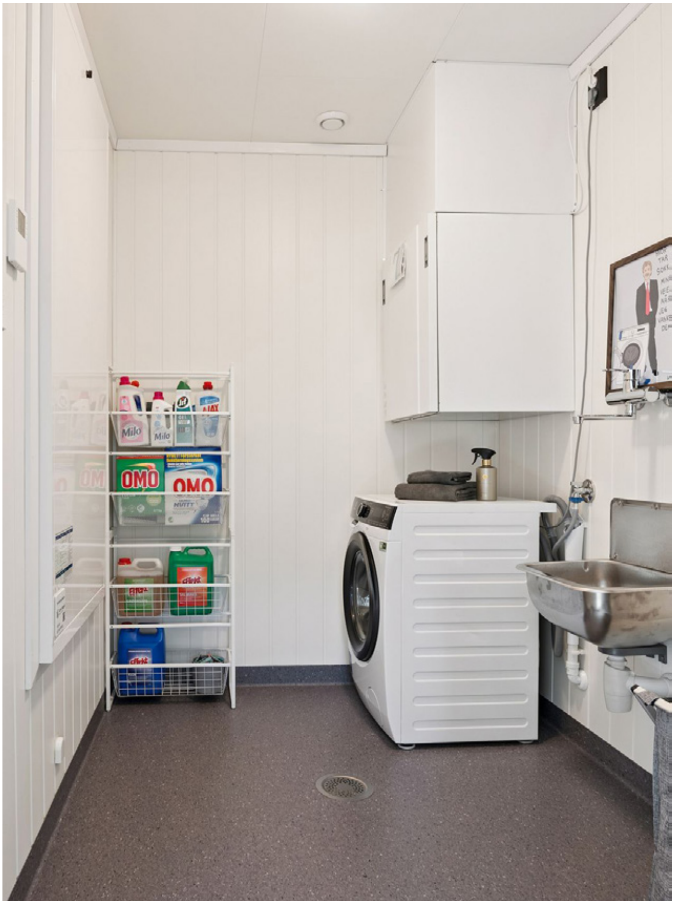
Teknisk rom/bod med opplegg for vaskemaskin og praktisk utslagsvask.
