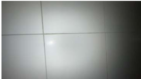
Riss i fuger
