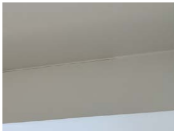
Eksempel på sprekker i listfrie overganger
