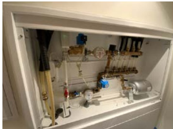
Vannfordelingskap med stoppekraner for varmt og kaldt vann.
