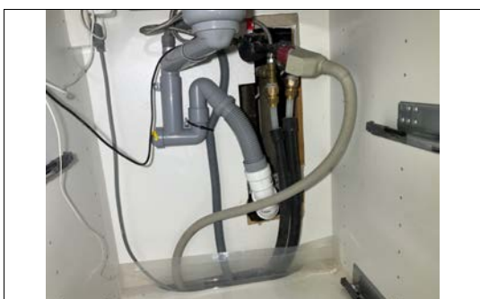
Rørpøplegg i kjøkkenbenk.
