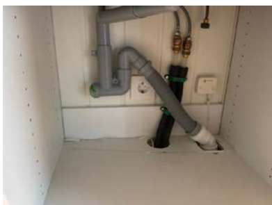
Det er montert vannstoppføler under vask, og ved åpning for vaskemaskin.
