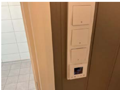
Elektriske varmekabler (ikke funksjonstestet på befaringsdagen)
