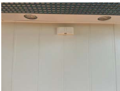
Det er montert komfyrvakt
