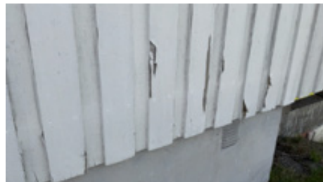
Eksempel på slitasje.
