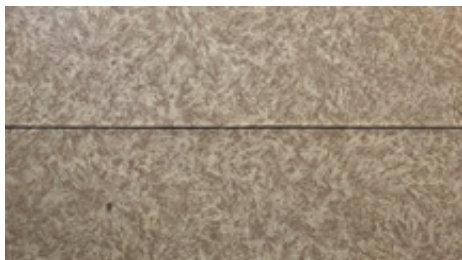
Gulvbelegg løsner i skjøter.
