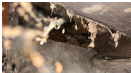
Råte i bunnstokk, observert fra kjeller under kjøkken.
