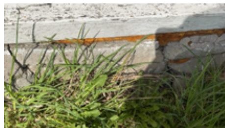
Eksempel på sprekk i grunnmur.
