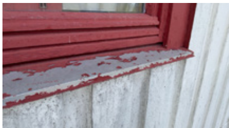
Slitasje på beslag
