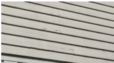
Struktur på overflate indikerer at det kan være råte i kledningsbord.
