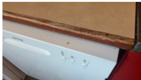
Eksempel på slitasje.
