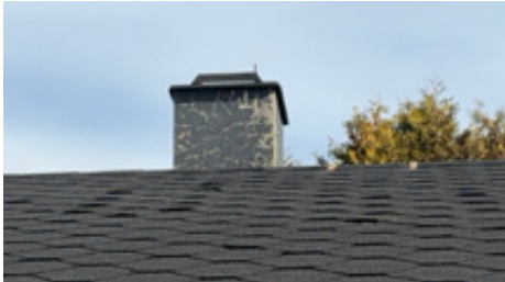
Slitasje og riss i pipe over tak.
