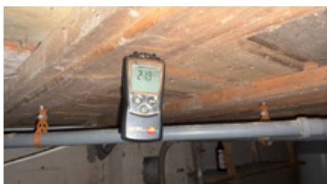
Fukttinnhold i konstruksjoner på over 20 vektprosent.
