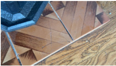
Eksempel på sprekker i fliser på gulv.
