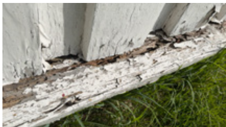
Eksempel på råteskade på vannbrett grunnmur.
