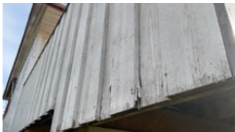
Eksempel på råteskader.
