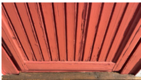
Slitasje på verandadør.
