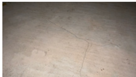
Eksempel på sprekker i gulv.
