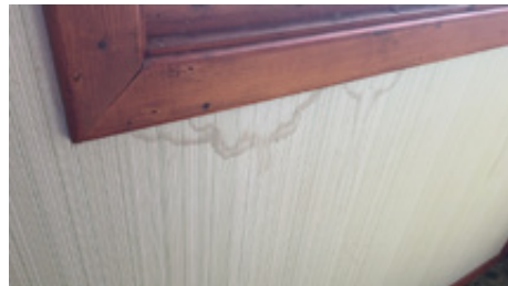
Fuktmerker under vindu på soveom.
