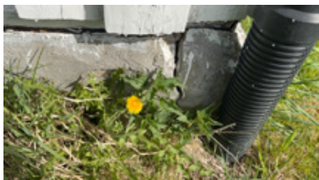
Eksempel på sprekk i grunnmur.
