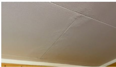
Svelling i himlingsplater på kjøkken.
