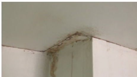
Fuktmerker rundt pipe i 2. etasje.
