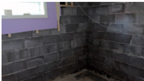
Konstruksjoner i ett rom er revet grunnet fuktpåkjenninger.
