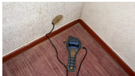
Fuktmåling i utforet vegg mot terreng viser et fukttinnhold på ca. 22 vektprosent.
