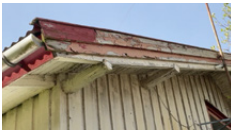
Slitasje på vindskier.
