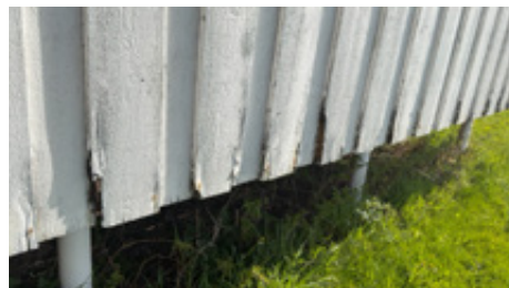
Eksempel på råteskader.
