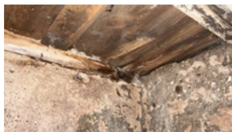
Synlig råteskade i himling.
