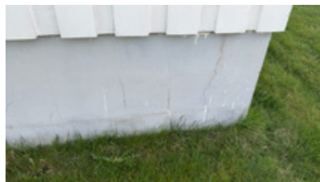
Eksempel på riss i overflater.
