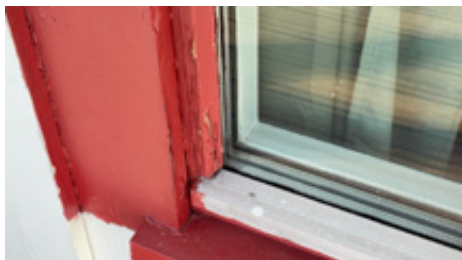
Eksempel på slitasje.
