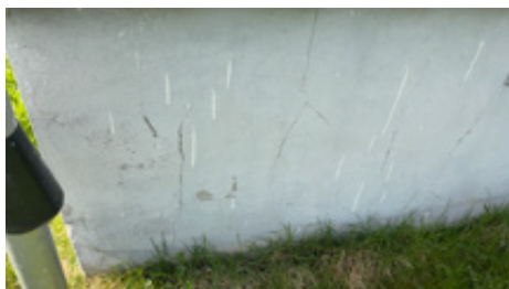
Eksempel på riss i overflater.
