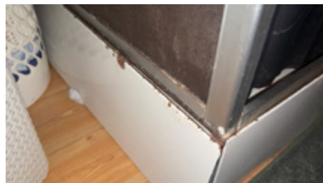
Slitasje på dusjkabinett.
