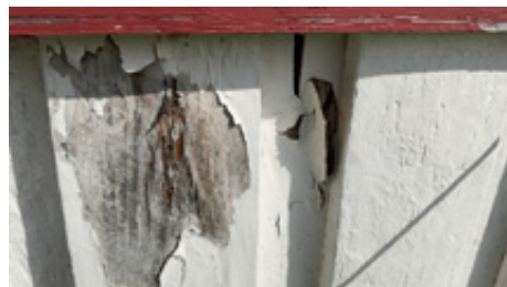
Eksempel på råteskade på fasadekledning.
