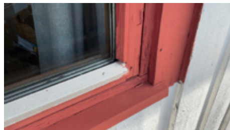
Eksempel på slitasje.
