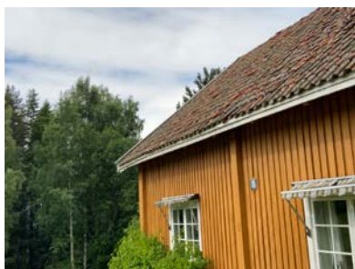
Takrenner mangler i sin helhet på én side
