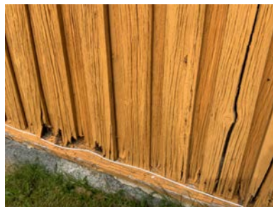
Det ser ut til at større deler av denne veggens bør skiftes.
