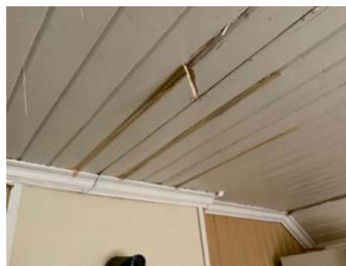
Himling har tatt skade fra fuktpåkjenning
