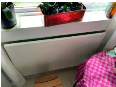
Eksempel på eldre panelovn
