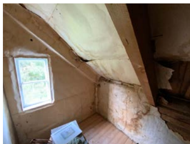
Tydelige merker etter fukt
