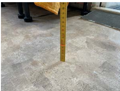
17 mm avvik på vilkårlig punkt i kjøkken
