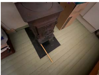
Ildsted andre etasje. For kort ikke-brennbar plate
