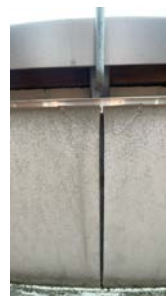
Plater med sprekker på rekkverk.
