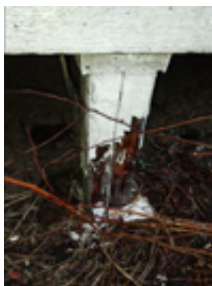
Råteskader ved tresøyler under terrasse.
