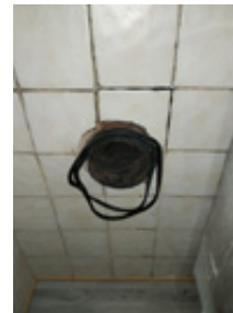
Åpent hull etter røykinnføringer i kjøkken. Flisforblendingen har sprekker, riss og ujevnheter, samt løsnede fliser fra underlaget. Det er også partielt manglende fugemasse i flisfugene.
