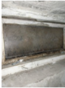
Flere vinduer med forhøyet fuktnivå og råteskader.
