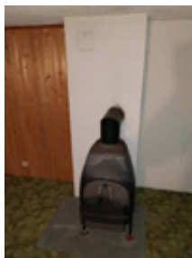
Tilknyttet vedovn i kjellerstue, brannsikring mot gulv med metallplate. Toppmontert røykgassrør uten feieluke. Vedovnen i kjellerstuen er oppklosset og plassert på treklosser.
