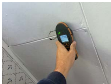
Gammel skade i takess kjøkken- ikke funnet unormal fukt
