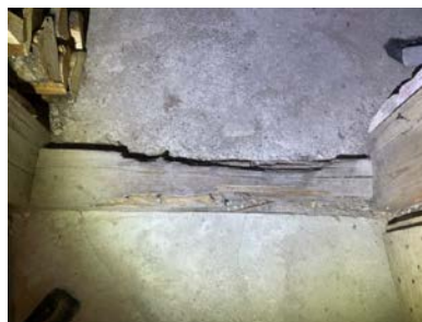
Råte i terskel tyder på at den har vært fuktbelastet tidligere
