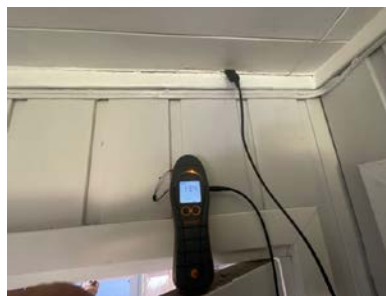
Pågående lekkasje entre ved spesielle værforhold- synlig økning ved fuktmåling i området
