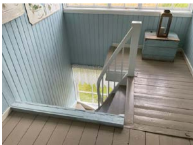
Manglende rekkverk trappeåpning 2.etg.
