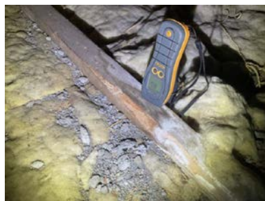
En skjolde på takkonstruksjon ved pipe, men ikke målt høyt fuktinnhold
