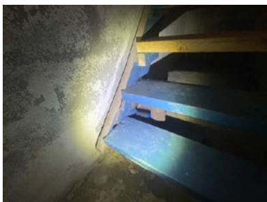
Råteskadet nedre del kjellertrapp
