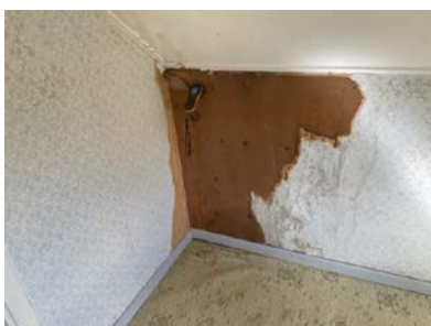
Soverom ved/under gradrennen som har hatt lekkasje.
