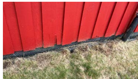
Værslitt kledning flere steder.
