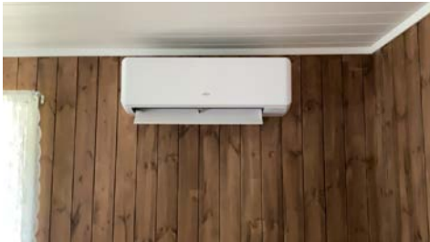
Varmepumpe fra 2025 på stue.
