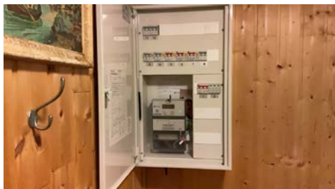
Sikringsskap på bod.
