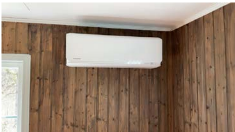
Varmepumpe i stue fra 2024.
