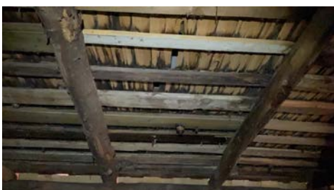
Hull i undertak flere steder.
