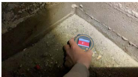
Ved enkle fuktsøk ble det registrert områder med unormale verdier.
