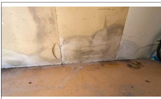
Veggplater i garasjen med fuktpåkjenning/-skader.
