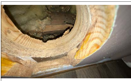
Inndregen mellom kjøkkenet og badet. Påvist muselort. Dette er symptomer på aktivitet fra skadedyr, ref. kommentar under punktet «Veggkonstruksjoner».
