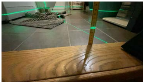
Høydeforskjell (flis ved terskel)
