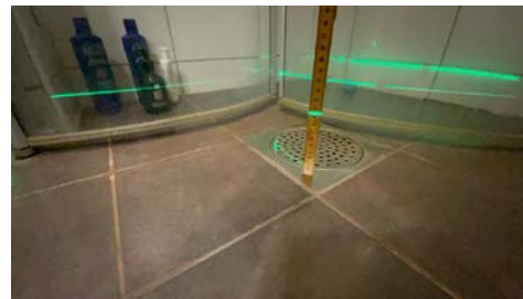
Høydeforskjell (ved sluk)
