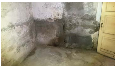
Saltutslag og fuktmerker på vegg, dette indikerer fuktvandring i vegger.
