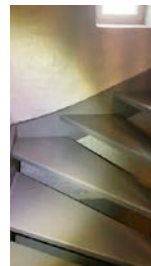
Trapp til kjeller mangler håndløper på vegg, og har større åpning enn dagens krav mellom opptrinn.
