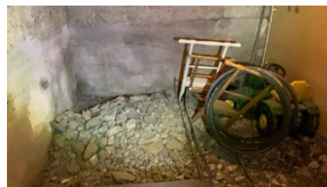
Jord-/steingrunn i ene rommet i kjelleren.
