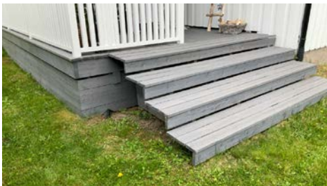
Det er ikke montert rekkverk på trappen.
