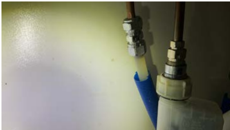
I kjøkkenskåp er det ikke tett tilslutning mellom varerør og vannrør på rør i rør opplegget.
