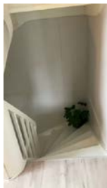
Trapp mellom 1.- og 2. etasje mangler håndløper på vegg.
