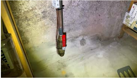
Innendig hovedstoppekran er plassert i kjeller.
