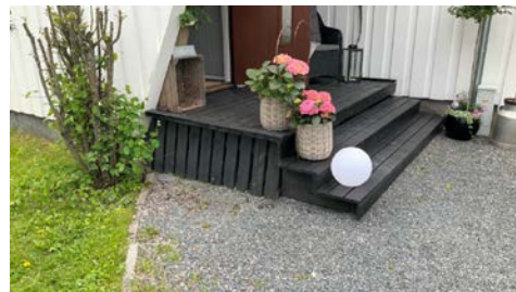
Det er ikke montert rekkverk på trappen.
