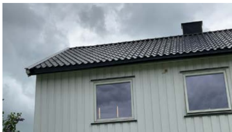
Takrenne er bøyd/deformert etter snøras eller ising i renne.
