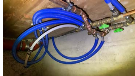
Vannrør er ikke lagt vannskadesikkert.
