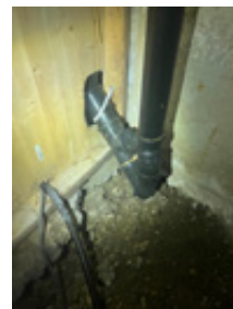
Avløpsrør med stakeluke i kjeller.
