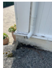
Takvann må ledes vekk fra grunnmur.
