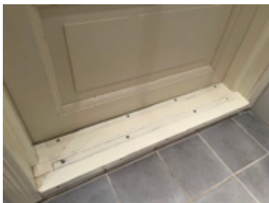
Manglende tilluft spalte under dørblad.
