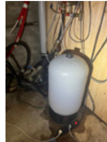
Trykktank og stoppekran i kjeller.
