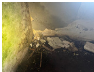
Avskallet murpuss er symptom på fukt.
