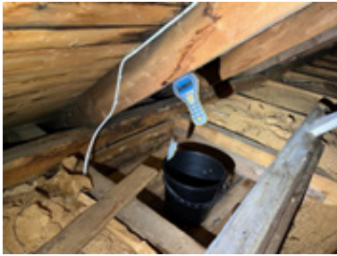
Kneloft med fuktmerker, fuktmåling viste normale verdier.
