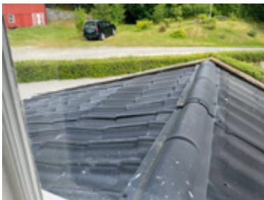
Takplater har skader.
