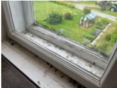
Eksempel på vindu med slitasje mellom glassene.
