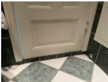
Manglende tilluft spalte under dørblad.
