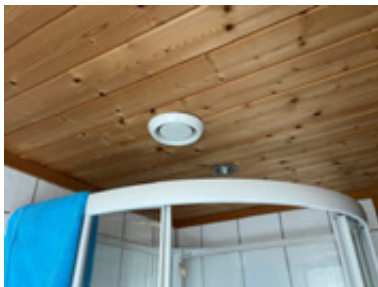
Naturlig avtrekk med ventil i himling.
