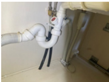
Varerør (svarte) i kjøkkenbenk mangler tettemuffer.
