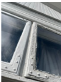
Eksempel på vindu utvendig der ett er behandlet og ett ikke.
