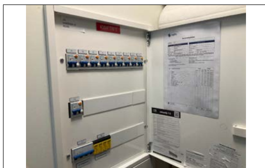
Sikringsskap med kursfortegnelse.
