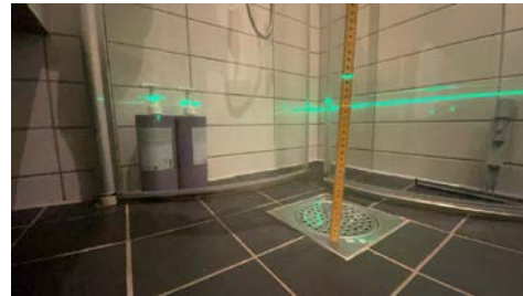
Høydeforskjell (ved sluk)
