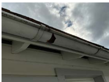
Lekkasje i overgang.
