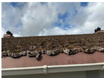
Mose og begroing på taket
