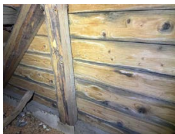
Fuktskjolder på treverk på yttervegg i gavel
