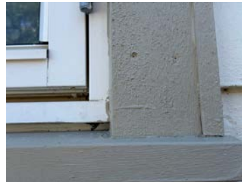
Vindusomramming står i kontakt med underbeslaget.
