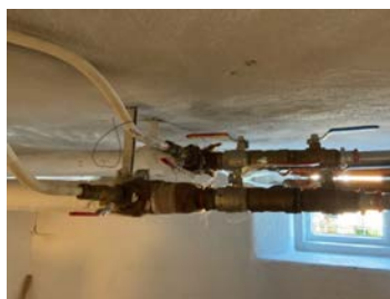
Stoppekraner i tak i kjeller
