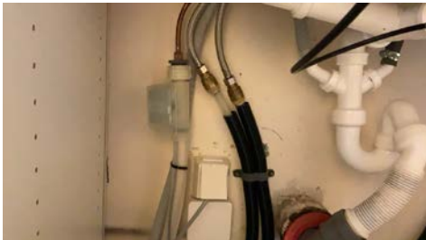
Det mangler tettemuffer i enden av varerør på rør-i-rør-system.
