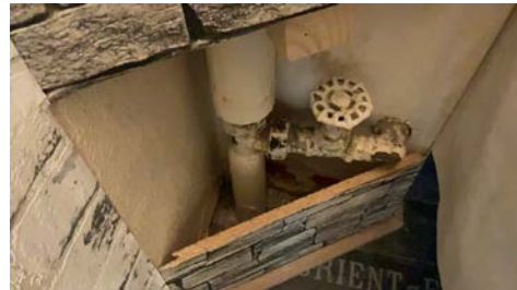
Stoppekran er plassert i toalettrom
