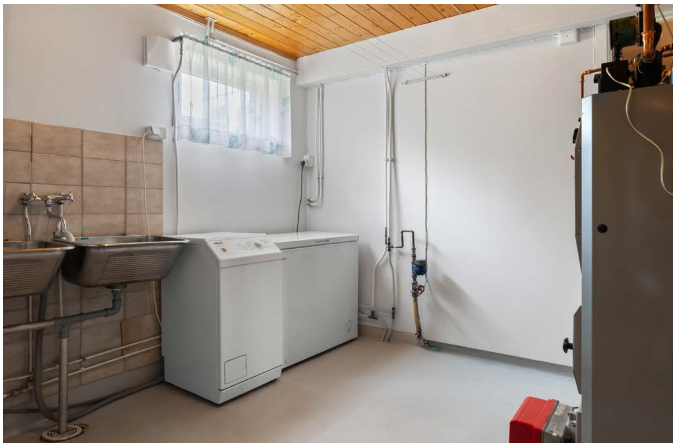
Vaskerom med boligens Bio sentralfyr, installert i 2023.
