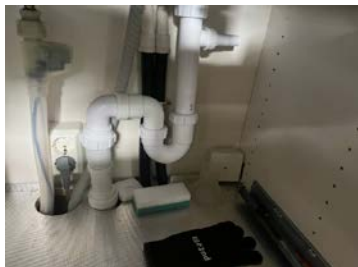
Røropplegget i kjøkkenbenken.
