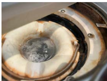
Sluket i dusjhjørnet.
