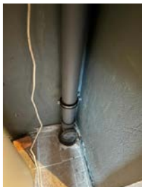
Avløpsrør av PVC, ført ned i rør av støpejern nedstøpt i gulvet.
