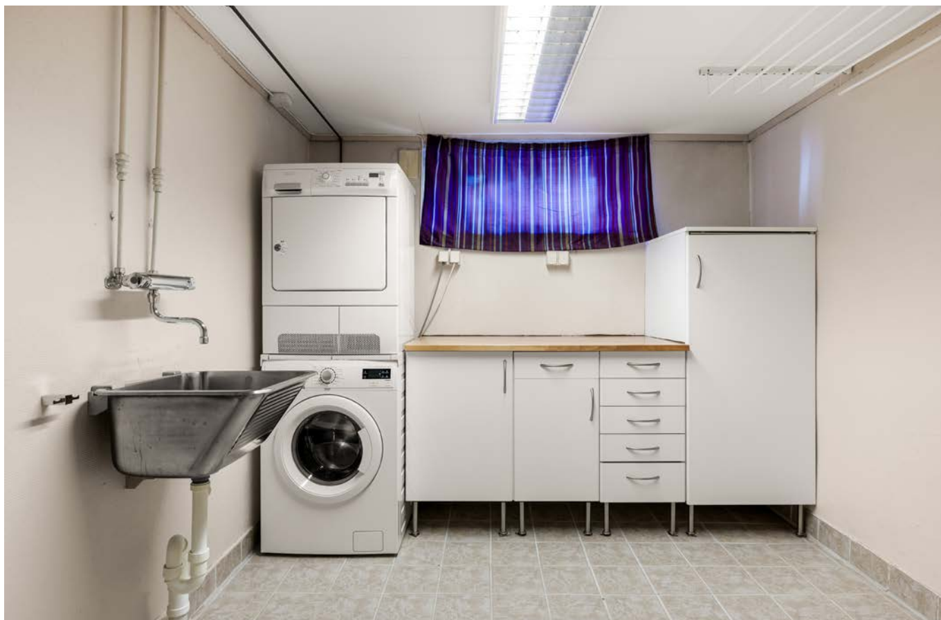
Praktisk vaskerom i kjelleren med flislagt gulv med varmekabler, oppgradert i 2015.
