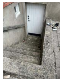
Utvendig trappehals til kjeller. Det er ikke montert rekkverk på toppen av trappehalsen.
