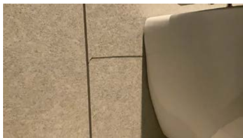
Sprekk i flis ved toalett
