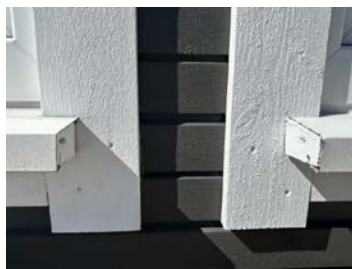
Vindusomramming står i kontakt med underbeslaget.
