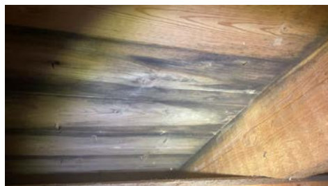
Undertaket er misfarget.
