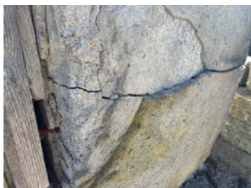
Sprekk i mur ved garasjeport
