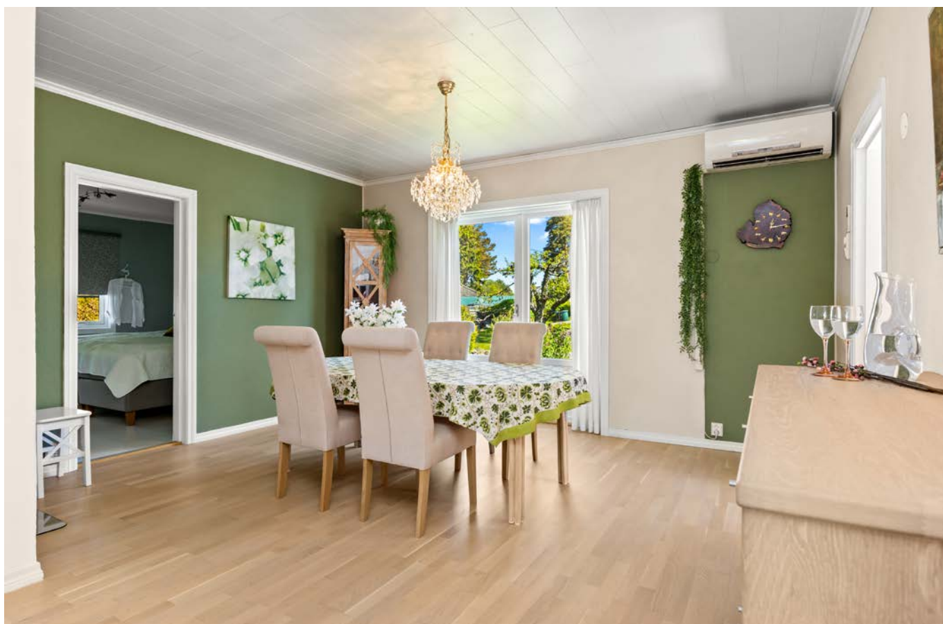
En luft-til-luft-varmepumpe fra 2012 bidrar til effektiv oppvarming.
