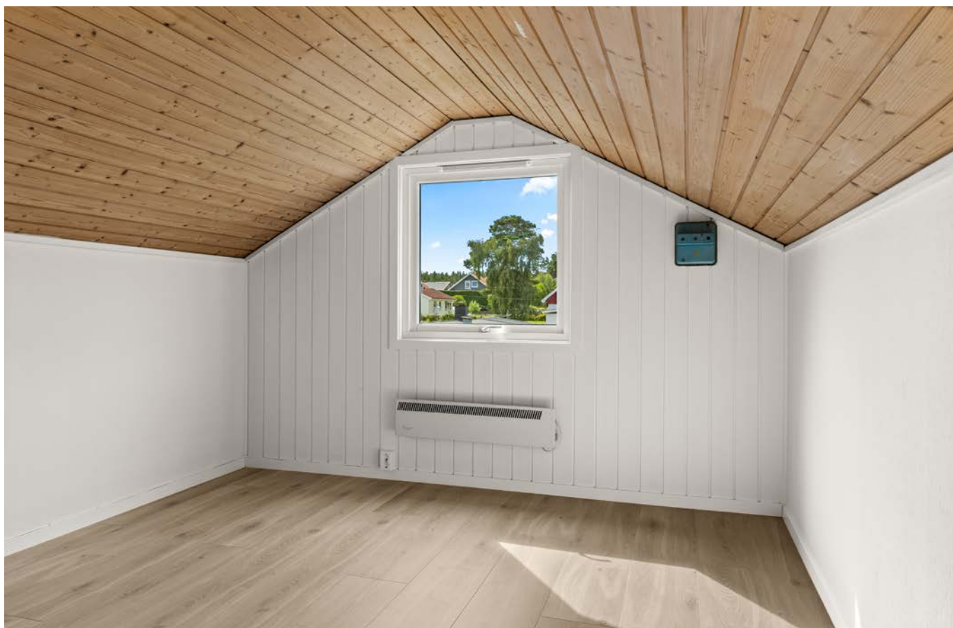
Rom i 2. etasje, tidligere benyttet som soverom. Rommet er ikke godkjent for varig opphold.
