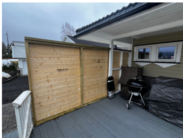
Mangler overflatebehandling levegg.
