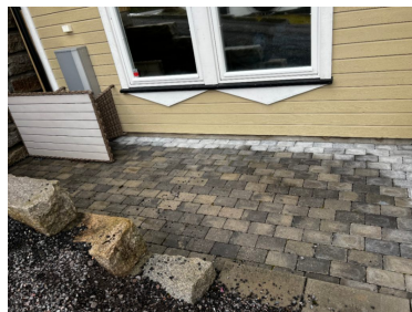
Manglende avstand mellom terreng og kledning
