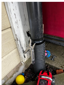
Råteskade i bord ved dør til utleiedel.
