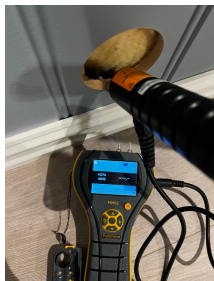
Fuktmåling fra gang bak dusjhjørnet.
