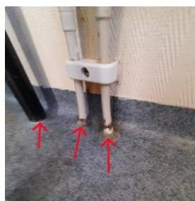
Her mangler påsveiset hylse ved rørgjennomføringer.
