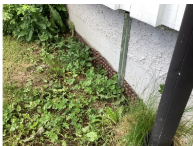
Topplister mangler på deler av grunnmursplasten.
