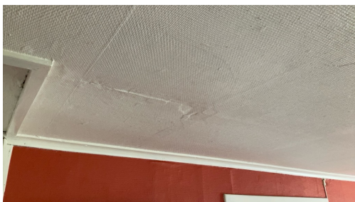
Skade/ slitasje på overflater.
