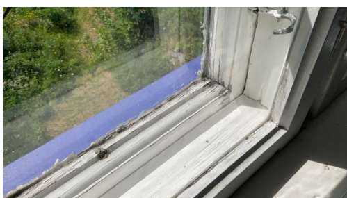
Skade/ slitasje på vindu.
