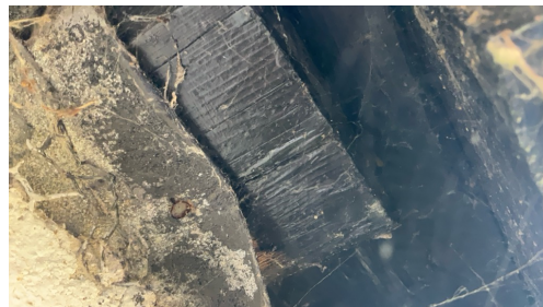
Åpning i veggkonstruksjon der mus kan komme inn.
