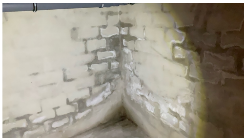
Fuktmerker på grunnmur.
