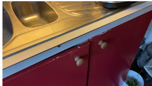
Skade/ slitasje innredning/ overflater.
