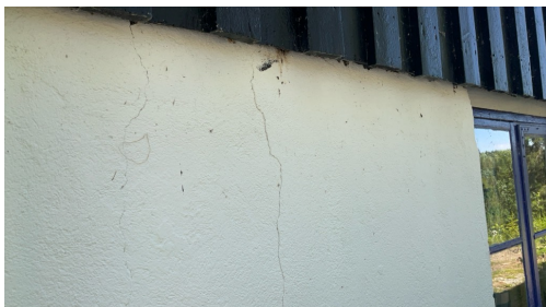
Sprekk/ riss på mur.
