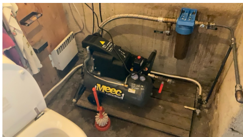
Installasjoner for vanntilførsel.
