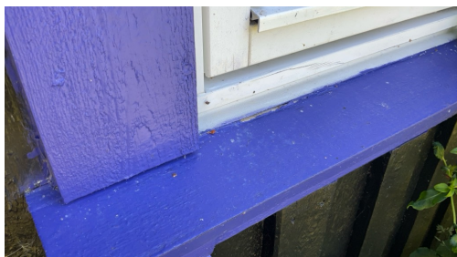
Manglende bsag på vannbrett
