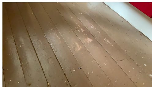
Skade/ slitasje på overflater.
