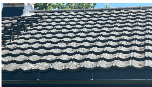
Mose/ groing på taktekingen.
