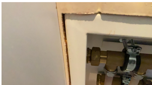
Gjennomføring skap rør-i-rør
