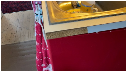
Skade/ slitasje innredning/ overflater.
