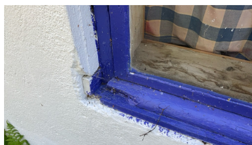
Skade/ slitasje på vindu.
