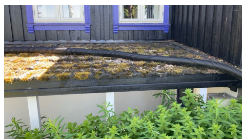
Mose/ groing på taktekingen.
