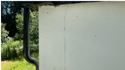
Sprekk/ riss på mur.
