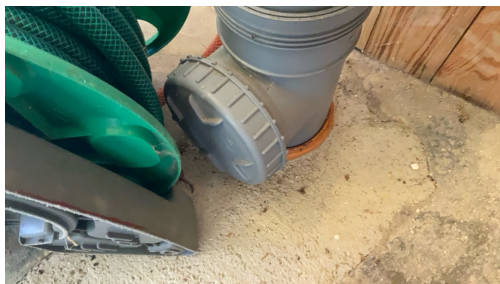
Stakeluke på avløpsrør.
