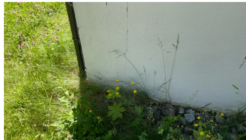
Sprekk/ riss på mur.
