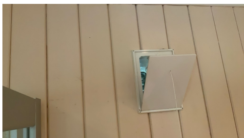
Ventil på vegg
