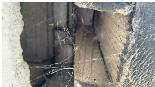
Ikke tilfredsstillende lufting av veggkonstruksjon.
