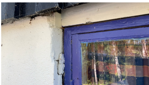
Manglende tetting rundt vinduer
