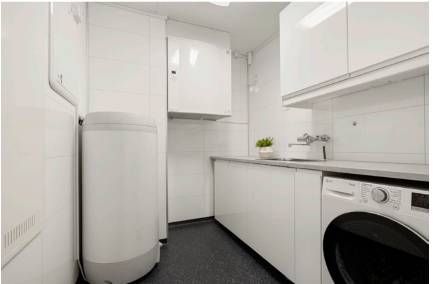
Stort vaskerom/ teknisk rom
