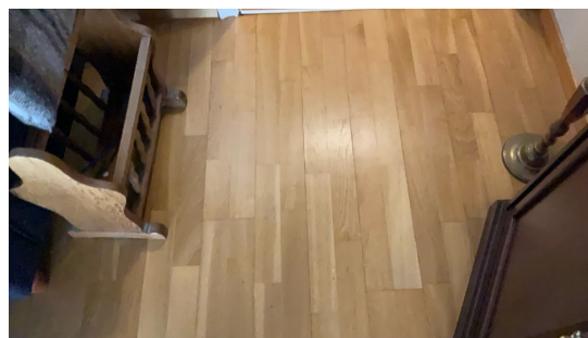
Sprikk/mindre åpning mellom parkettbord.
