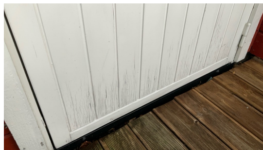
Værslitt/oppsprikking av brystning på balkongdør.
