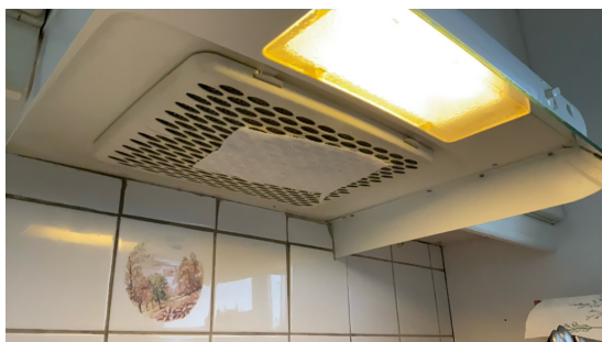
Ventilator funksjonstestet med papir.
