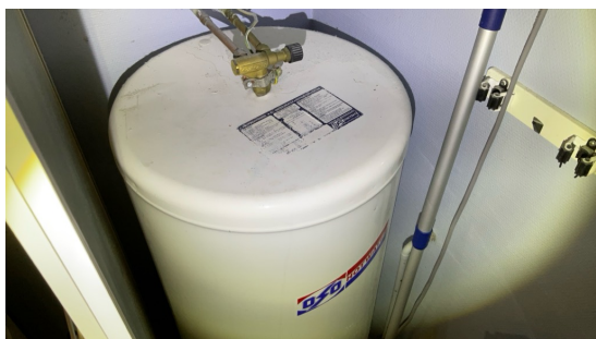
Varmtvannsbereider fra byggeår.
