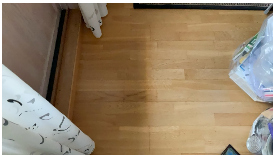
Falming av parkett, her ved balkongdør.
