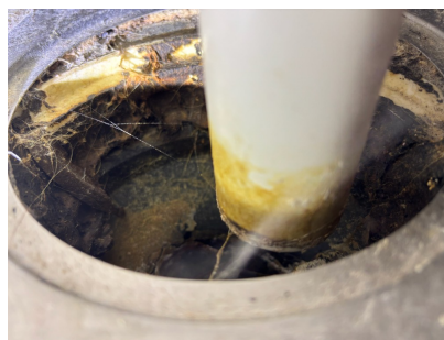
Sluk under dusjkabinett.
