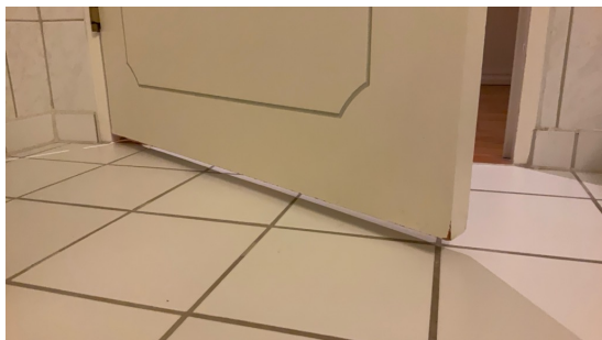
Fuktskader/svellinger på nedre del av dørblad til bad.
