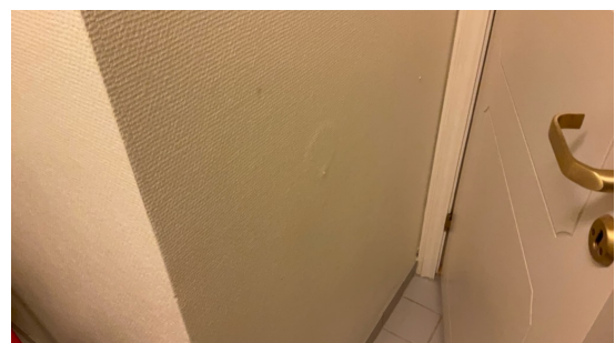
Bl.a merke i vegg bak dør.
