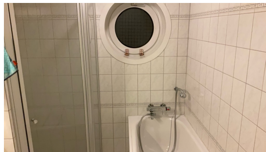
Vindu plassert i dusjens og badekarets fuktsone.
