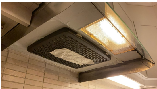
Ventilator funksjonstestet med papir.
