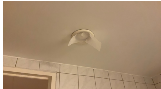
Avtrekk funksjonstestet med papir.
