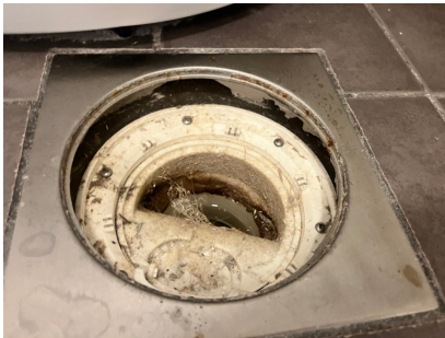
Sluk på vaskerom
