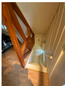
Trapp med store åpninger i rekkverk
