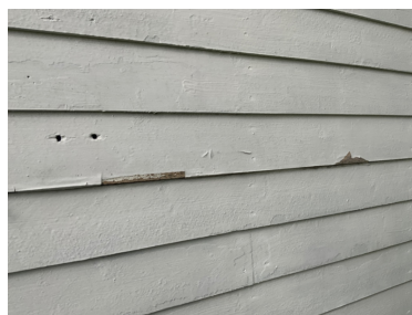
Avflassing av maling
