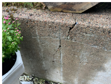
Sprekk i forstøtningmur.
