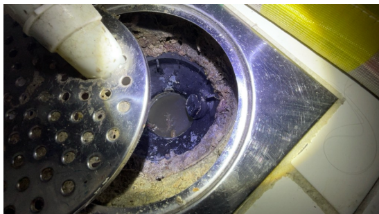
Sluk i gulv, uten synlig membran.
