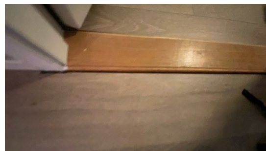
Det mangler terskellist mot dør til gang.
