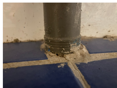
Utett rørgjennomføring i gulv under servantskap
