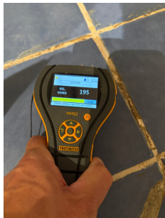
Høye fuktverdier og misfarga fuger i dusj.
