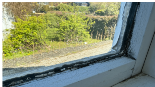
Fuktskader i karm på innsiden.
