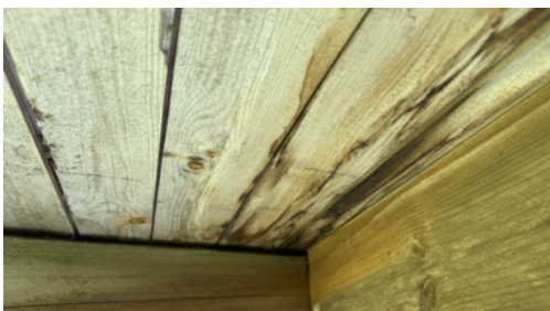
Fuktskjolder under balkong.
