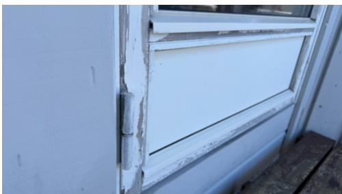
Maling har flasket bort på balkongdør.
