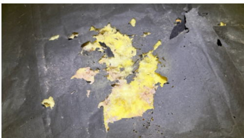
Skader i isolasjon etter gammelt musebesøk.
