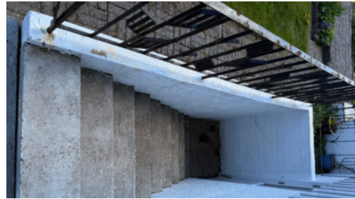
Støttemuren buler utover.
