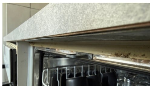
Påbegynnende svelling på benkeplate over oppvaskmaskin.
