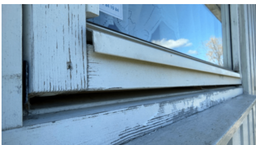
Enkelte av vinduene har værslitte karmen.
