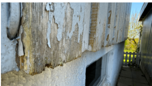
Stedvis råteskadet kledning.
