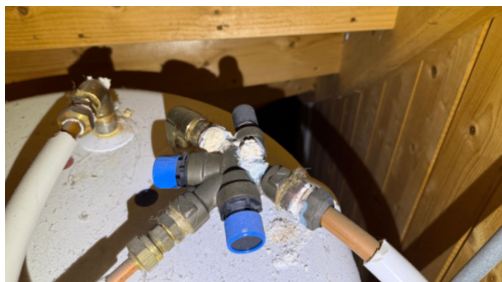
Irr og kalkavleiringer.
