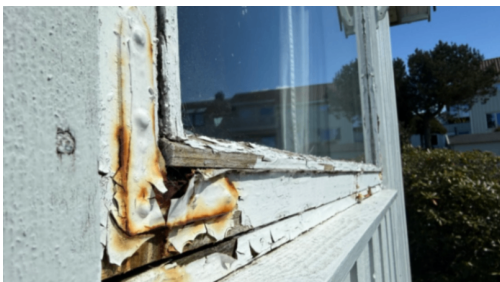
Generelt stor slitasje på de eldre vinduene.
