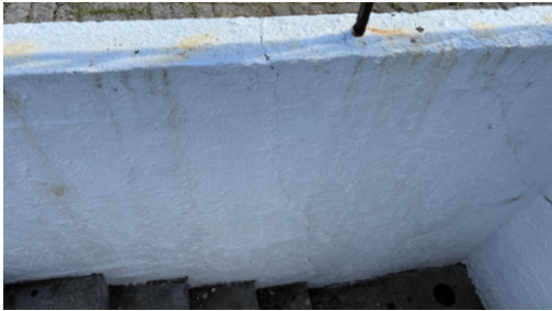
Vertikale sprekker i muren.
