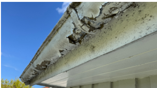
Stedvis stor slitasje på takrenner.
