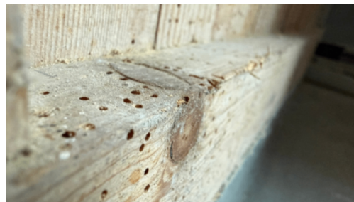
Vegg mot bad har vært angrepet av borebiller.
