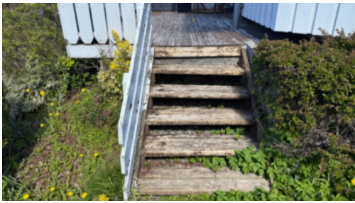
Tretrapp til terrasse er i dårlig forfatning.
