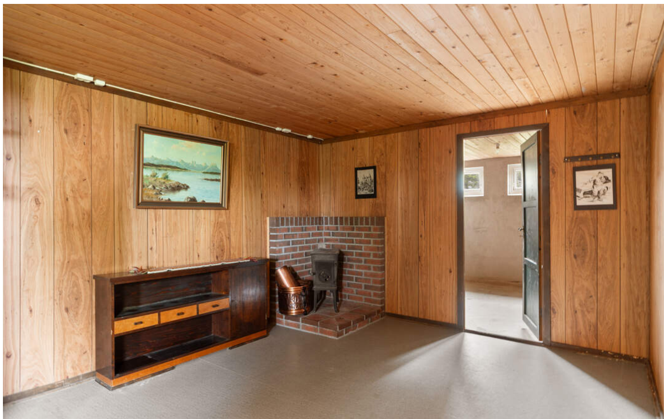
Rom brukt som kjellerstue (ikke byggemeldt og godkjent til varig opphold)
