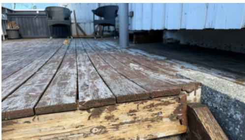
Terrasse har store skjevheter.
