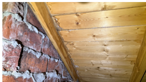
Fuktskjolder ved pipe.
