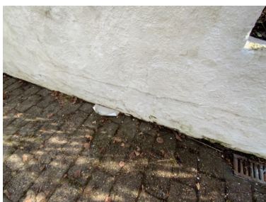
Skjevheter sprekker i støttemur
