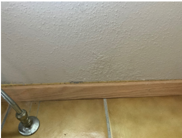
Fuktmerker nederst i yttervegg
