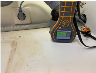
Fuktmerker i kjøkkenbenk
