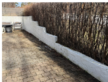
Skjevheter sprekker i støttemur
