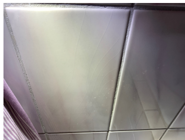
Krakelering i veggflis
