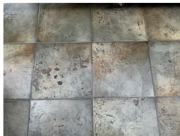
Bom og skader i fliser
