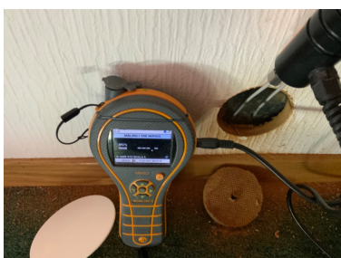
Fuktundersøkelse i vegg inn mot badetrom 2. etasje
