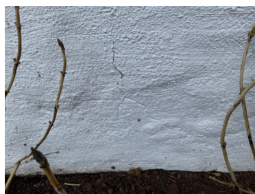
Mindre sprekker i murpuss
