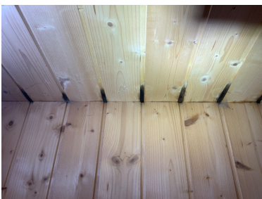
Merker etter luftlekkasje
