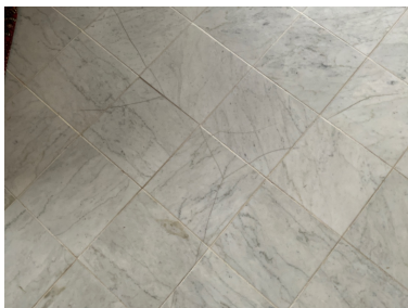
Sprekker i fliser stue
