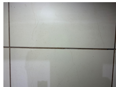
Sprekker i fugemasse
