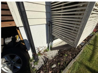
Lufte og påfyllingsrør til oljetank
