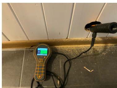
Fuktundersøkelse i vegg inn mot baderom kjeller
