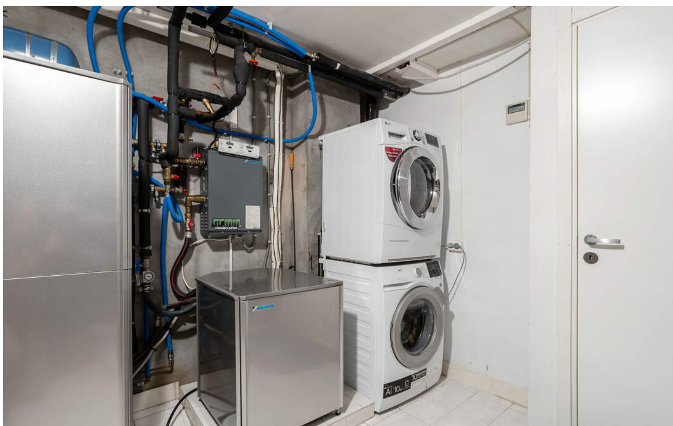
Vaskerom/teknisk rom - boligen har luft-til-vann varmepumpe
