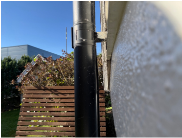
Sprukne nedløpsrør i skjøt/sveis.
