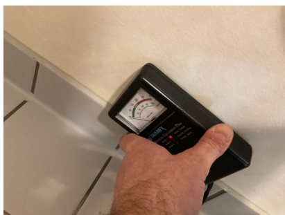
Bildet viser ingen tegn til lekkasjer ved bruk av fuktindikator på veggoverflaten.
