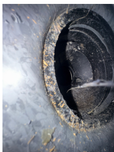
Bildet viser at tettesjikt synes å ha en tett forbindelse til sluk, klemt inn under klemring.
