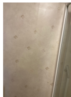
Bildet viser større skruer hull etter tidligere utstyr som er tettet med fugemasse.
