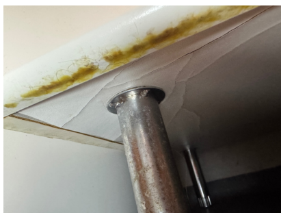
Bildet viser sprekker i bunnplate og bein som er presset litt inn i bunnplaten.
