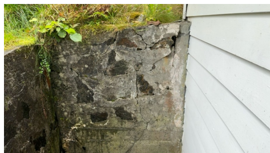
Riss i mur
